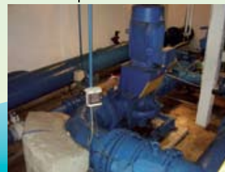
Prerušovacie vodojem Krásno nad Kysucou - malá vodná elektráreň
