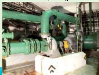
Úpravňa vody Nová Bystrica - malá vodná elektráreň
