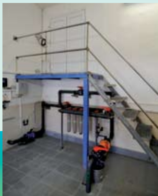
vodajem Belá - technológia úpravy vody
