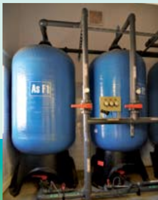
vodajem Belá - technológia úpravy vody
