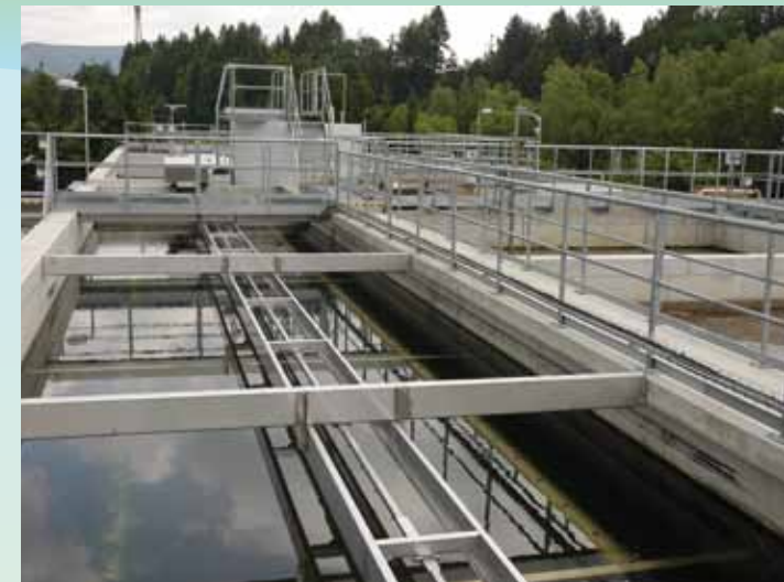
Biologický stupeň - po rekonštrukcii
