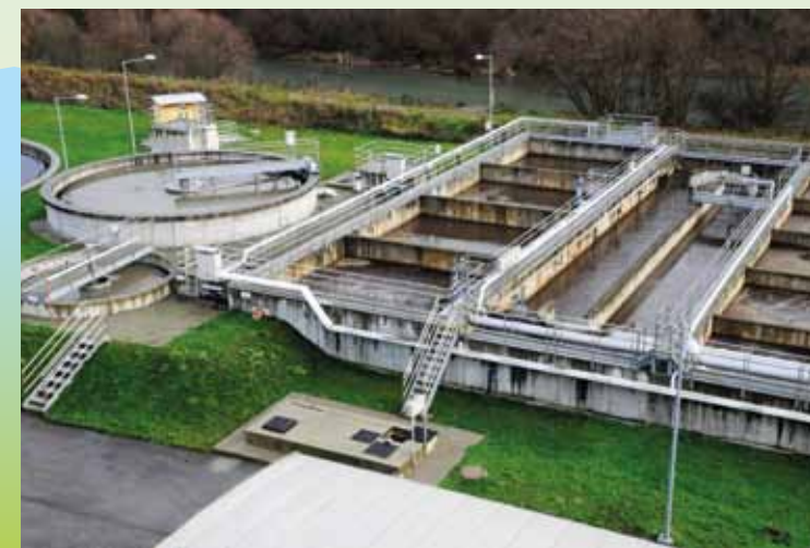
ČOV K. N. Mesto, biologický stupeň
