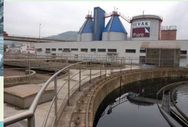
ČOV Čadca, dosadzovacie, vyhnívacie nádrže a kalojem
