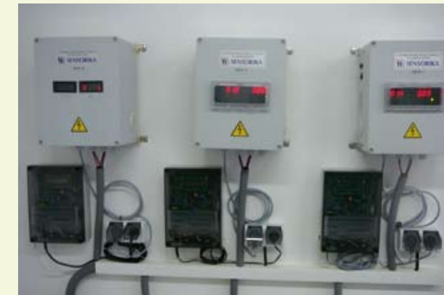
ČOV Čadca, katódová ochrana
